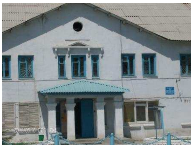
Здание отдела внутренних дел г. Дальнегорска, куда были доставлены около двадцати задержанных подростков. Фото: Фонд «Общественный вердикт»
